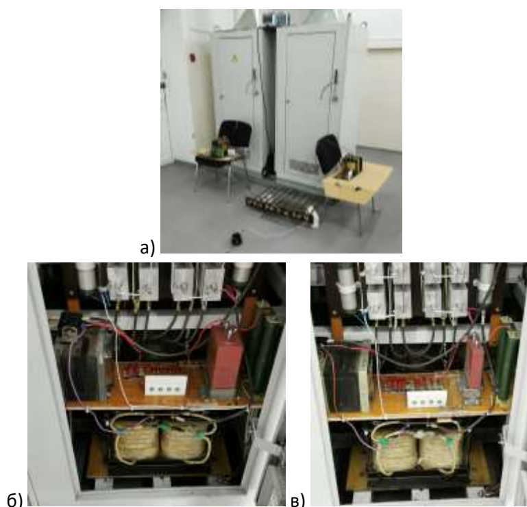
Рис. 2. Фотографии а) установки во время эксперимента и после монтажа оборудования в корпус источника питания б) нижнего катода (первый канал) и в) верхнего катода (второй канал).
